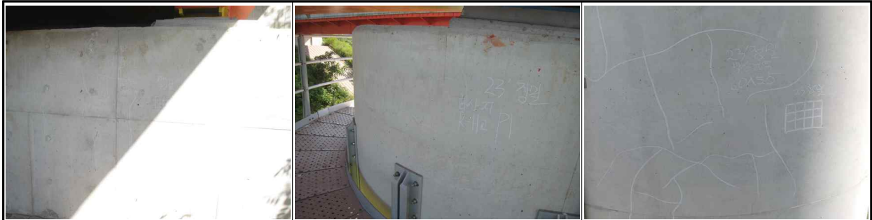
① 하부구조 망상균열 - 진전 여부확인, 추가 손상 발생여부 확인
