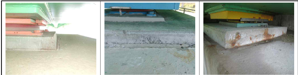
① 교량받침 균열(0.3mm이상), 단면손상 - 진전 여부확인
